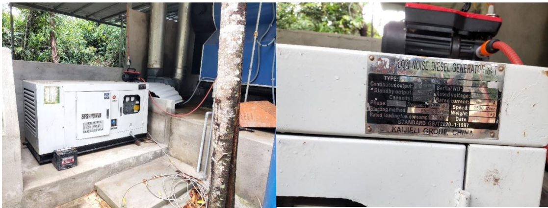
Hình 1.8: Khu vực máy phát điện dự phòng KAIJIELI GROUP, CHINA công suất 10kVA
