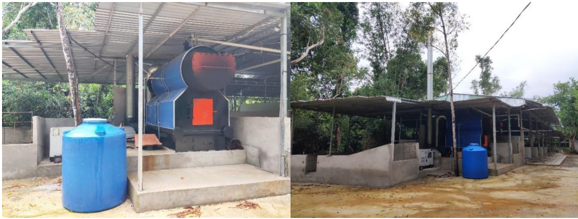
Hình 1.7: Khu vực lò hơi và ống khói
