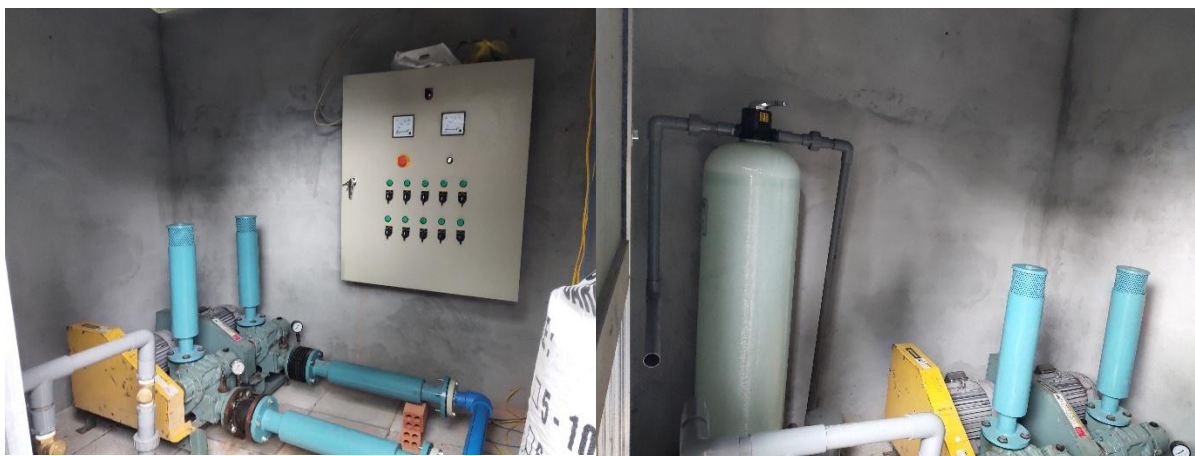
Hình 1.15: Khu vực tủ điều khiển và thiết bị lọc áp lực
