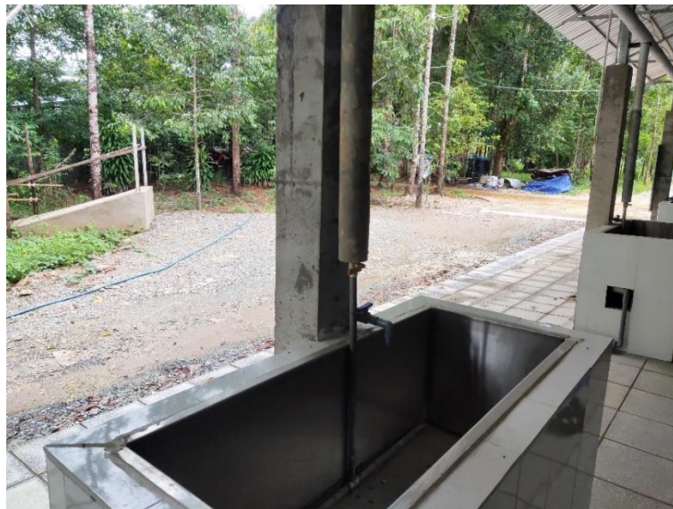
Hình 1.11: Khu vực lọc huyết với 5 bồn inox và sử dụng nước nóng từ lò hơi
