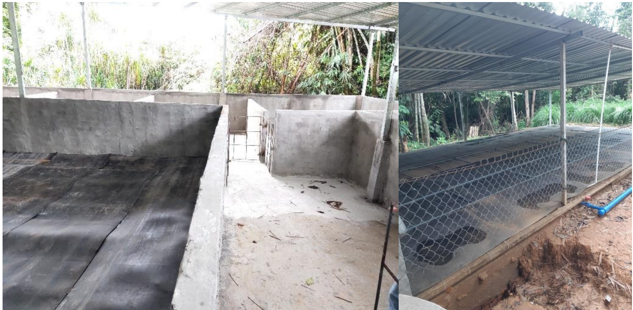
Hình 1.14: Khu vực hệ thống xử lý nước thải xây âm và phủ bạt bề mặt bể dạng HDPE dày 4,0mm
